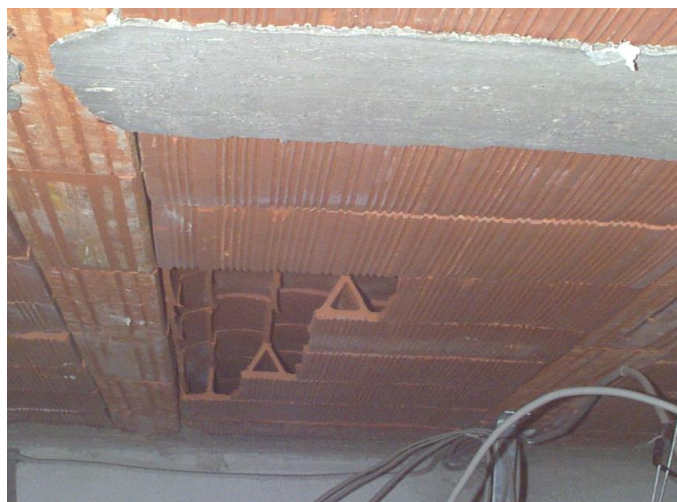
Slika 1 - Tipično oštećenje na stropu
