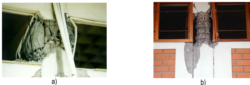
Slika 1 – Primjeri oštećenja kratkih stupova: a) detalj peterokatnice izgrađene 1997. godine prema Grčkim propisima za proračun konstrukcija otpornih na potres [1]; b) spone Ø10 na razmaku od 10 cm nisu spriječile teška oštećenja na stupu nastala djelovanjem potresa [2]
