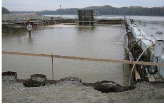
Poplavlivanje i problemi građevinske jame temeljenja pilona mosta na Dravi
